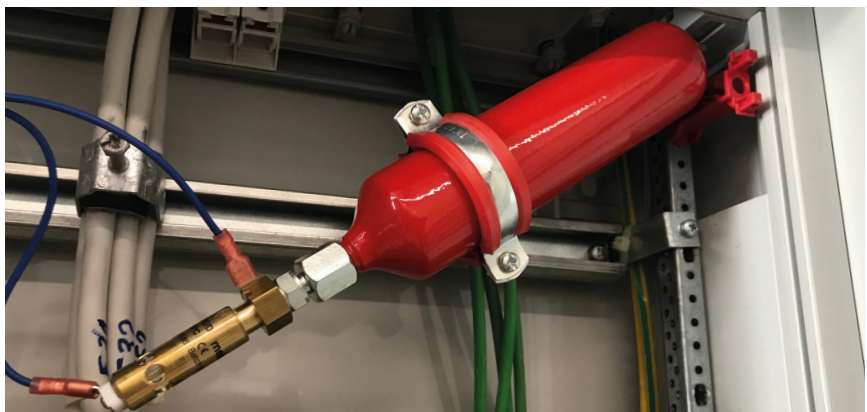
Fernauslösbare R-AMFE im Schaltschrank bei FTI Reisen
