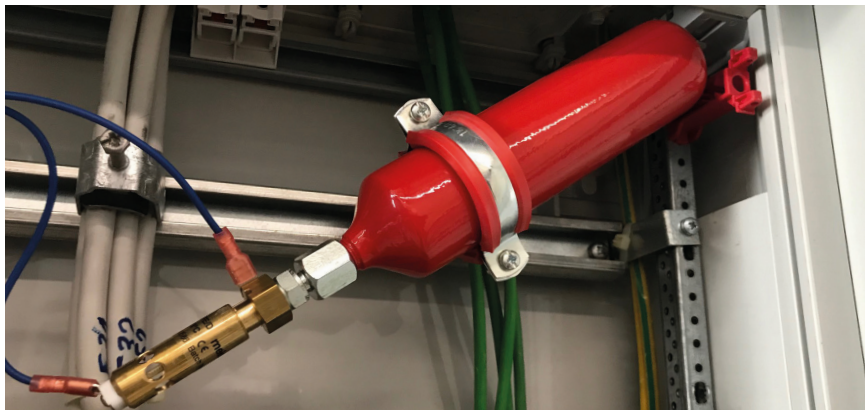
Fernauslösbare R-AMFE im Schaltschrank bei FTI Reisen
