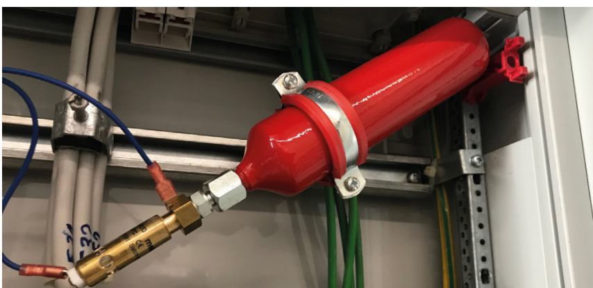
Fernauslösbare R-AMFE im Schaltschrank bei FTI Reisen
