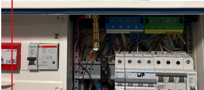
Integration der R-AMFE Einheit im Schaltschrank
